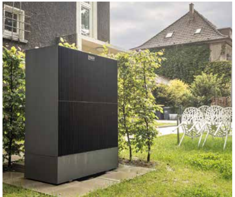
Beispiel für eine Wärmepumpe, die bereits im Stillen Winkel installiert wurde. Foto: André Schuster
