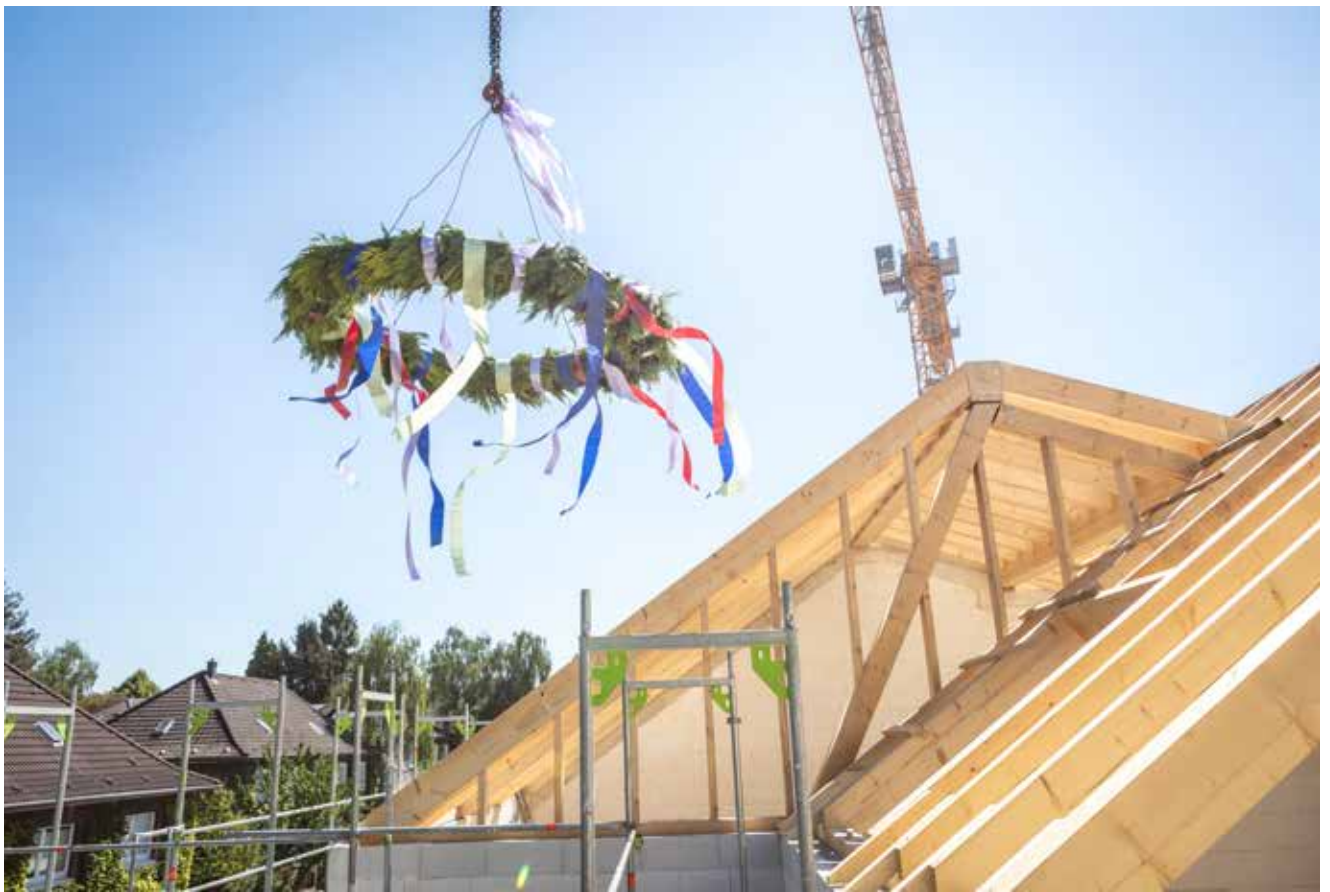
Nach drei Jahrzehnten wehte wieder ein Richtkranz, der auf der Margarethenhöhe im Floristik-Fachgeschäft von Susanne Oehlke gefertigt wurde, über einem Neubau der Margarethe Krupp-Stiftung.
