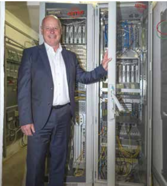
Jochen Biefang, Prokurist und Leiter der Wohnungswirtschaft, an einem Schaltschrank für das MMKS-Netz.
