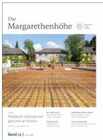
Unser Titelbild entstand bei der Herstellung der Erdgeschossplatte für den Waldpark Lehngrund.
