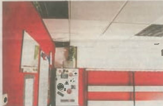
Die Umkleiden beim Tusem weisen etliche Schäden auf und genügen auch optisch nicht den aktuellen Ansprüchen.
