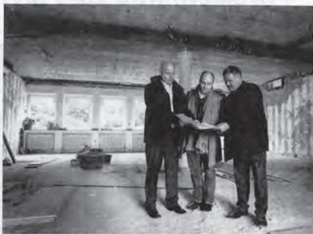
Umgebaut werden die Räume der ehemaligen Sparkassen-Geschäftsstelle für die neue Praxis. Das Bild zeigt Arzt Christian Schilf (Mitte) mit Jochen Biefang (L.) und Michael Flachmann (r.) von der MKS. FOTOS: JULIA TILMANN / FFS
