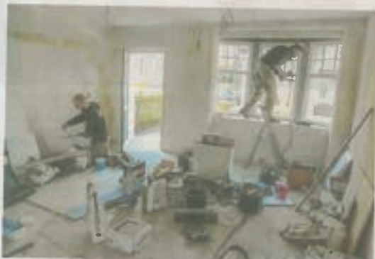
Derzeit laufen die Renovierungsarbeiten in den Räumen des ehemaligen Kloiidtadens am Laubenweg 11.
