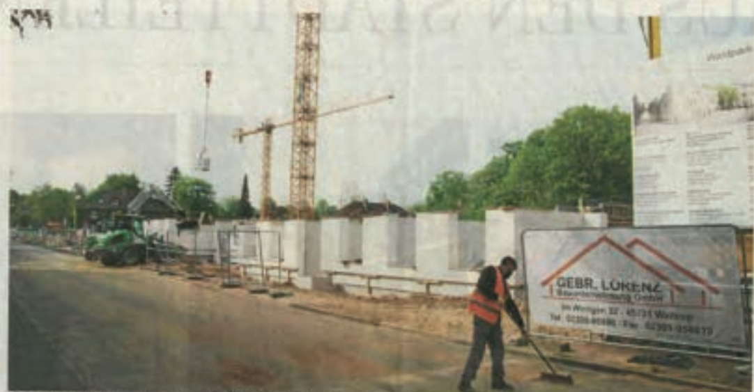
Die neuen Wohnhäuser am Lehngrund auf der Margarethenhöhe nehmen Form an. Einzug soll im Herbst 2023 ein. DANICA FREDRICKS/PHO
