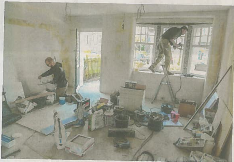
Derzeit laufen die Renovierungsarbeiten in den Räumen des ehemaligen Kloiddtadens am Laubenweg 11.
