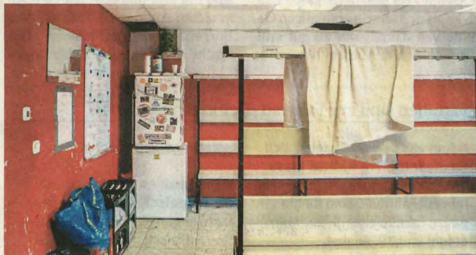
Die maroden Kabinen werden im Zuge der Sanierung komplett umgebaut und neu aufgeteilt.
