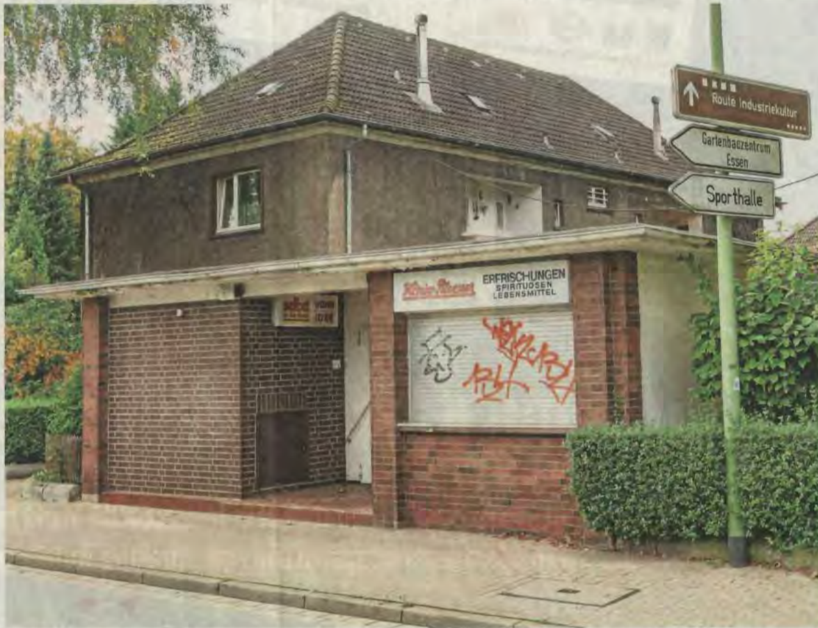
Verschlissen und beschmiert: Das kleine Gebäude an der Sommerburgstraße, das früher den Kiosk beherbergte, soll deutlich attraktiver werden.
