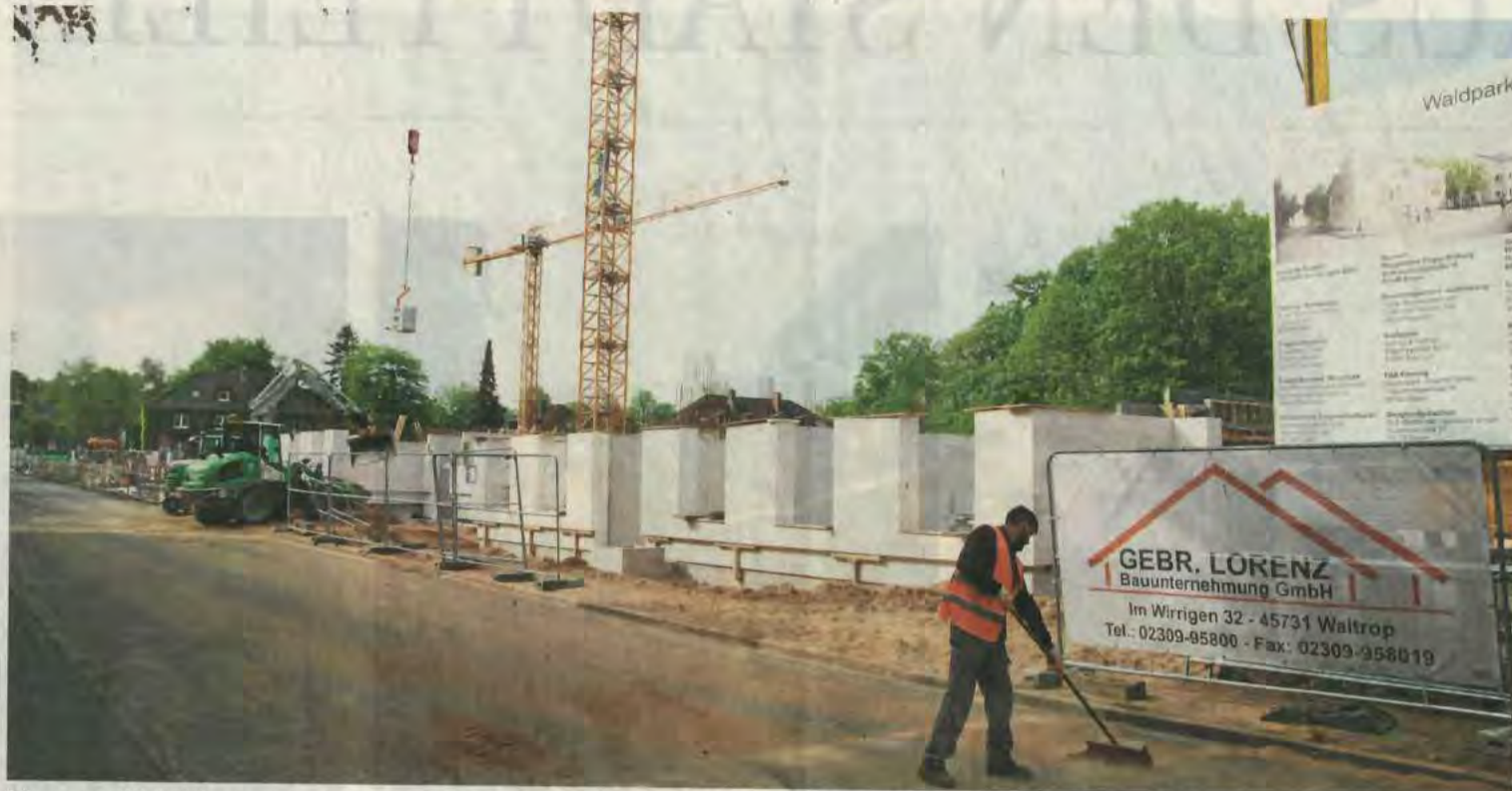
Die neuen Wohnhäuser am Lehngrund auf der Margarethenhöhe nehmen Form an. Einzug soll im Herbst 2023 ein.
